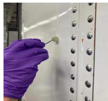
Figure 6. Application du produit de scellement
