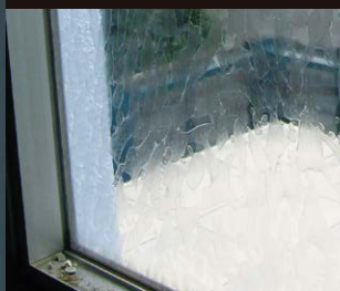
粘着面の浮き
