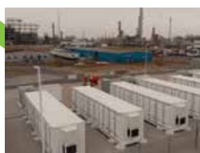
Sistemas de armazenamento de energia com baterias
