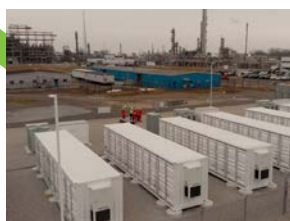
Almacenamiento de energía con baterías.
