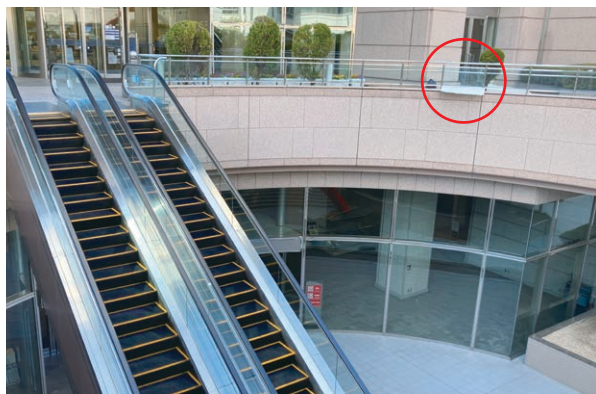
ガラスが割れた箇所（エスカレーター上のガラス手すり・赤丸部分）の周辺写真。
