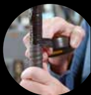
Isoler les chutes de câble
