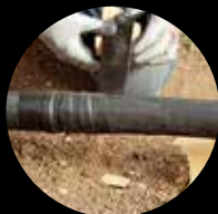
Provisorische Reparaturen von geringfügigen Rissen an Kabelmänteln
