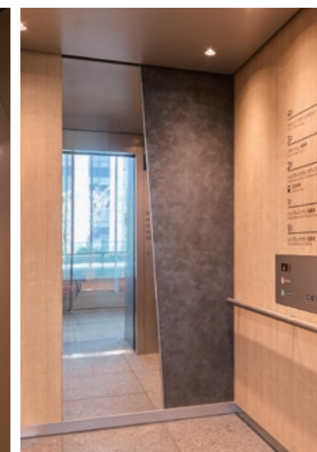
エレベーター内 AE-2159、DW-2203MT
