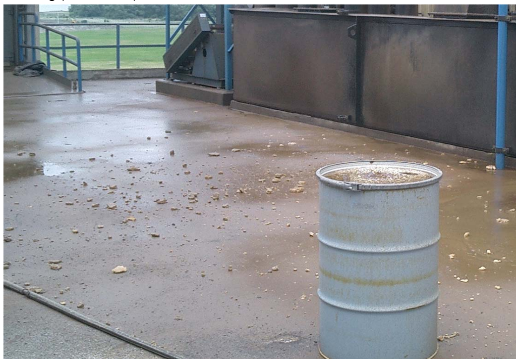
Product op het dak van gebouw 3 : witte emulsie-achtige neerslag (14/05/2007)
