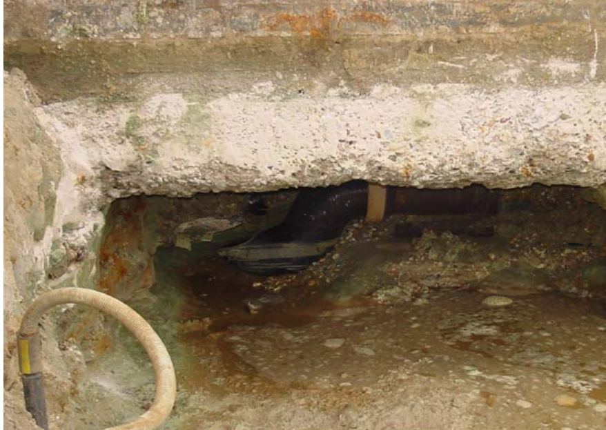
Locatie lek in leiding en voorlopig herstelling in afwachting vervanging leiding – aantasting beton.
