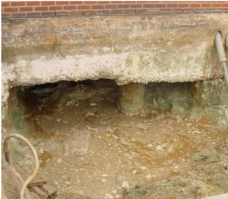
Zicht op bouwput na blootlegging leidingen door ontgraving : zicht op neerslag en aantasting beton.
