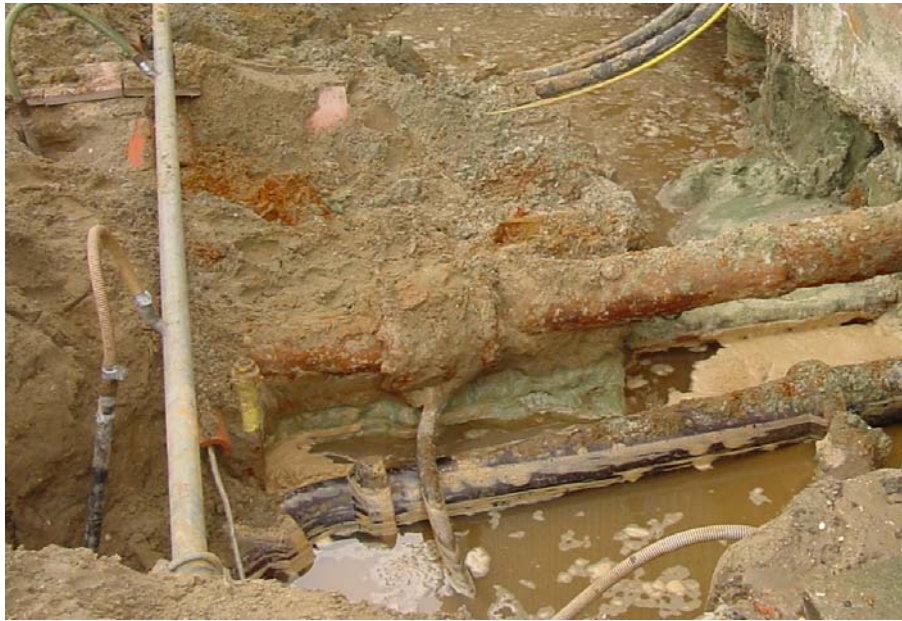
Zicht op bouwput na blootlegging leidingen door ontgraving: groenkleuring grond.
