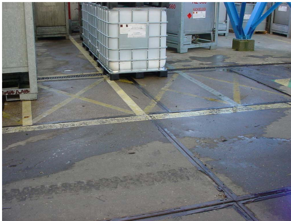
Foto van de toestand na vaststelling van de spill (05/10/2007)
