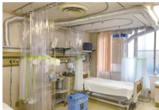
図1 ビニールカーテンと陰圧ダクトによる陰圧個室化
