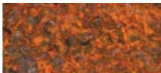
Zonder behandeling voor corrosiebescherming
