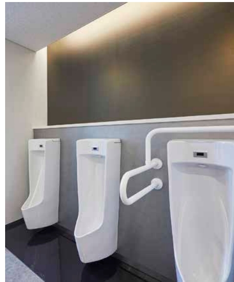
AM-1699 / 壁面上部 FA-1166 / 壁面下部
