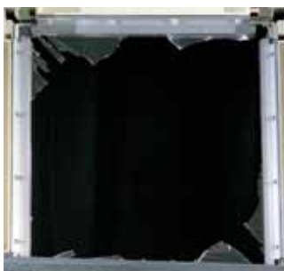
ガラスのみ（ガラスが割れて脱落）
