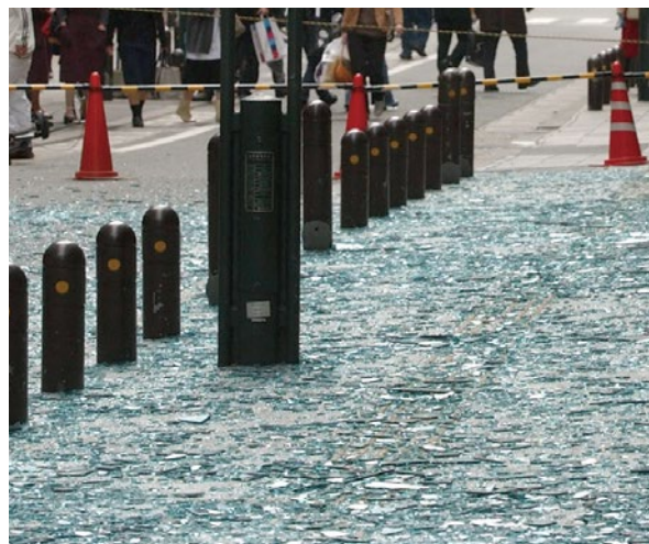
▲地震によって硬化性パテ止めのはめごろし窓のガラスが破損し、路上に落下・飛散した。
