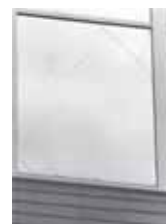
飛散防止フィルムを施工した窓ではガラスが破損しても飛散を防ぎました。
