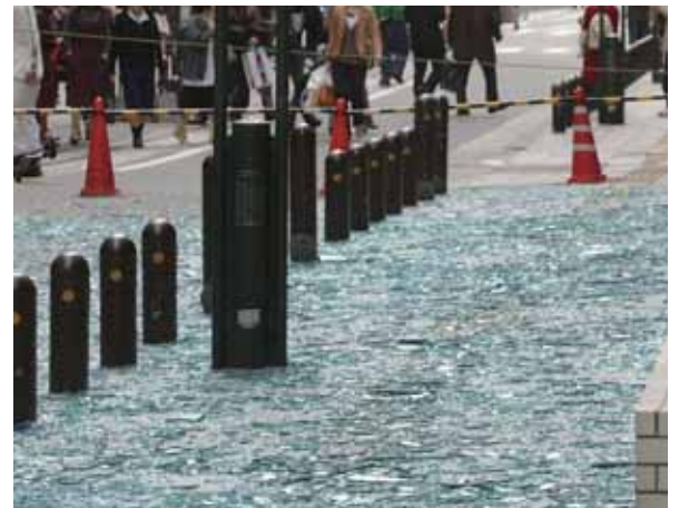
地震によって硬化性パテ止めのはめごろし窓のガラスが破損し、路上に落下・飛散した。
