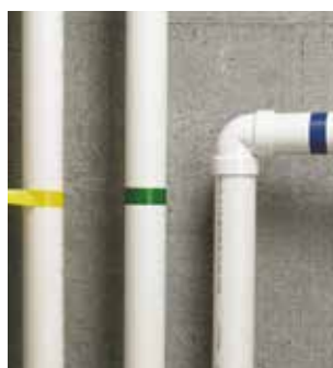
工場配管の識別
