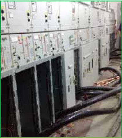
变电站内,10kV入柜电缆
