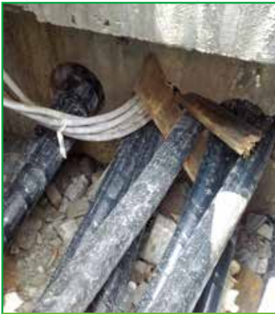
变电站外,10kV电缆外线进线部位
