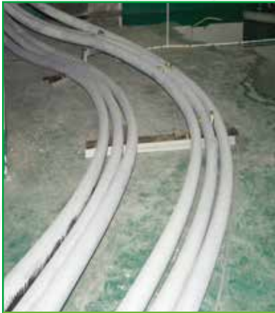
变电站内,10kV并排电缆密集部位
