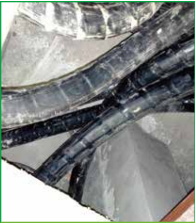
变电站内,10kV电缆转弯部位
