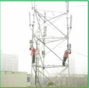
3G移动基站全景,由3个智能天线板相互间隔120度角形成对周边的覆盖
