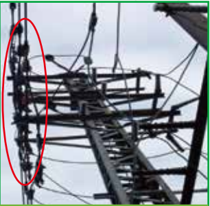
10kV架空绝缘导线的耐张线夹引落处
