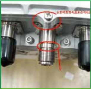
智能天线板下部RRU输出端接头
