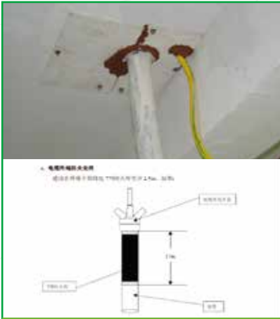
变电站内,10kV电缆终端部位,其 上方穿过封堵层为入柜电缆终端。 (防火带应用如示意图)
