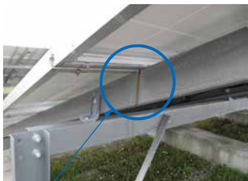
流水が原因と思われる架台に発生した錆の事例
