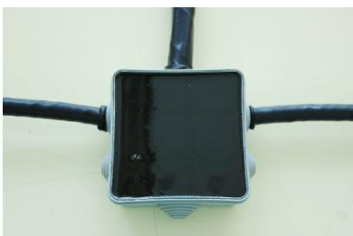
Рис. 17 Распаячная коробка с ответвлением кабеля, залитая твердым полиуретановым компаундом Scotchcast® 40
