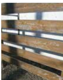
老朽化したフェンス
